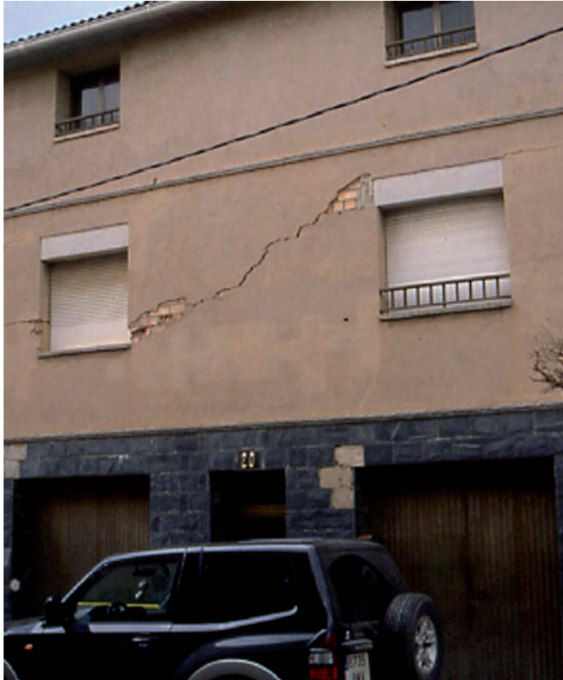
Fig. 156 Edifici afectat per la subsidiència del subsòl.
