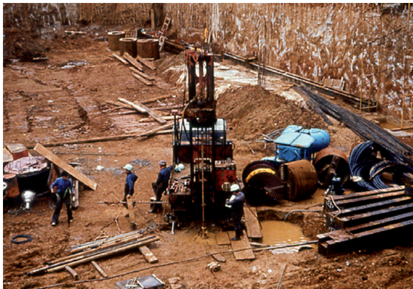
Fig. 193 Ampliació de l'estudi geotècnic deguda a l'aparició inesperada del nivell freàtic.
