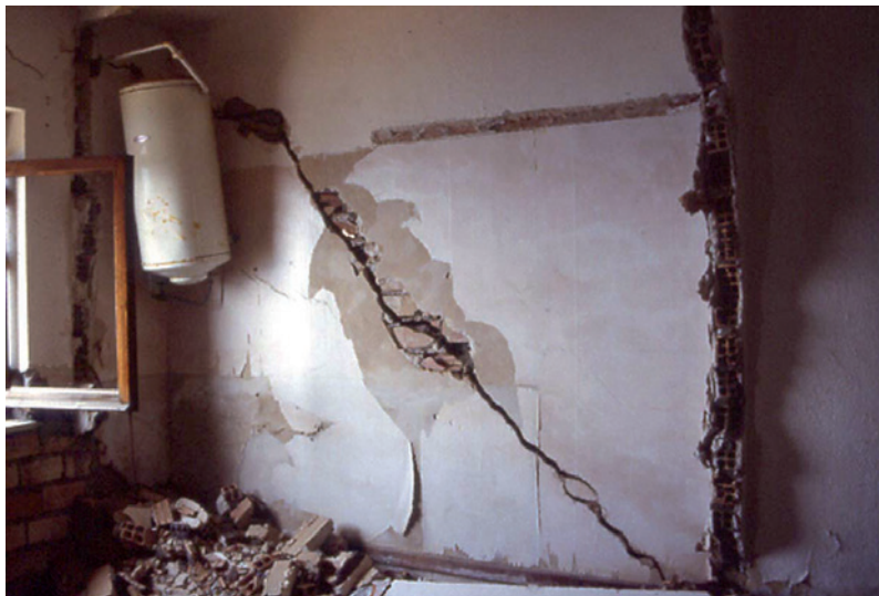
Fig. 157 La inestabilitat del sòl és incompatible amb la construcció.
