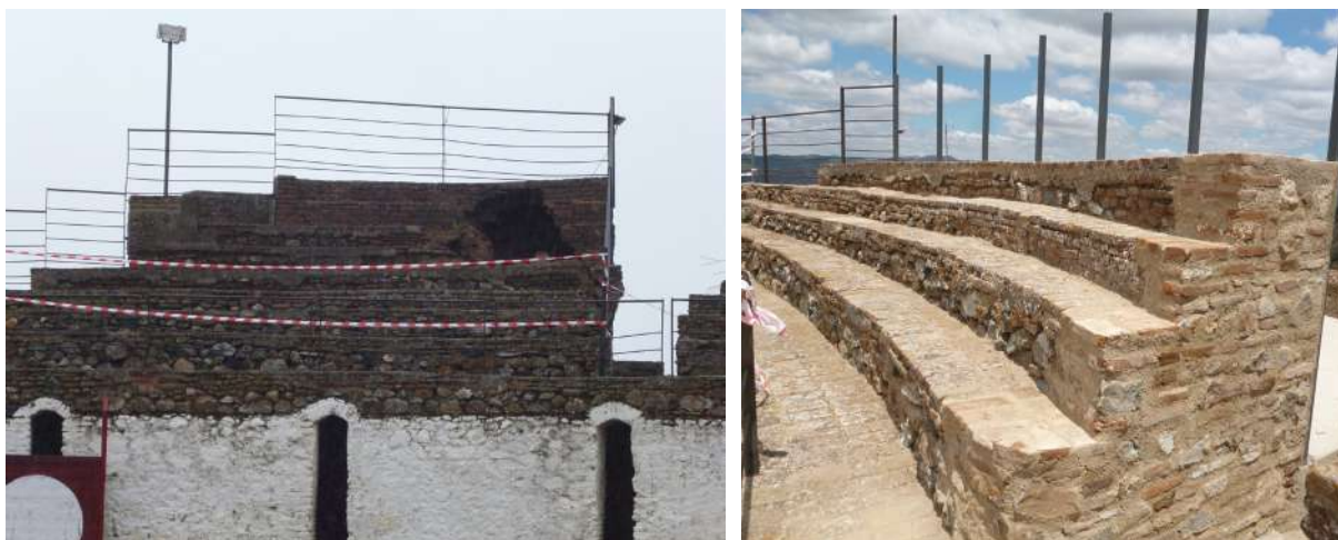
Fig. 76 y 77. Vista del socavón en el graderío y la posterior consolidación y colocación de las nuevas barandillas de protección (Fotos N. Medina).
