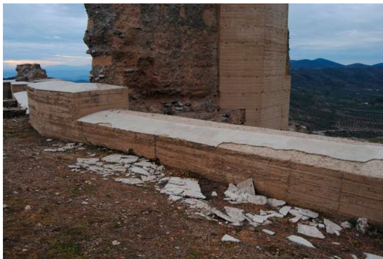
Fig. 157. Detalle del deterioro de las estructuras restauradas (Foto N. Medina).
