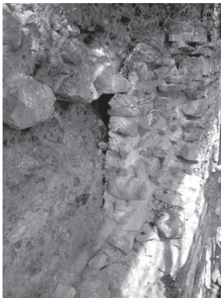
Figura 5: Aparejo toledano que se adosa a la fábrica de tapial como reparación de la misma en el castillo de Aroche.
