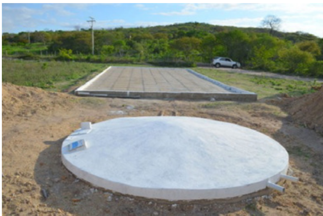
Figura 01 – Cisterna calçadão. Fonte: Instituto Nacional do Semiárido (2017)
