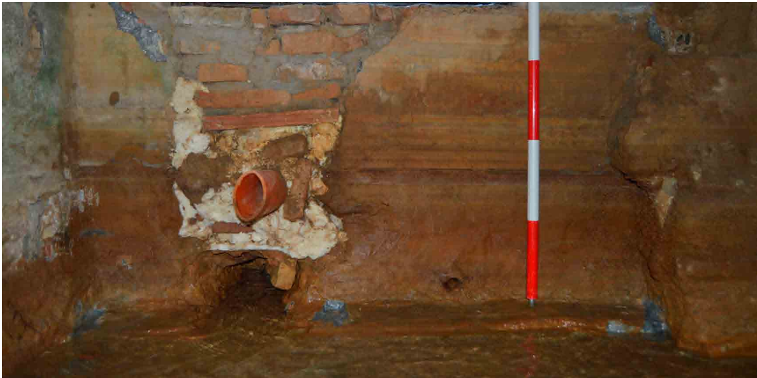
Figura 37. Zapata y zócalo de ladrillos del paramento occidental, con importantes alteraciones causadas por la apertura de los diferentes canales de desagüe.
