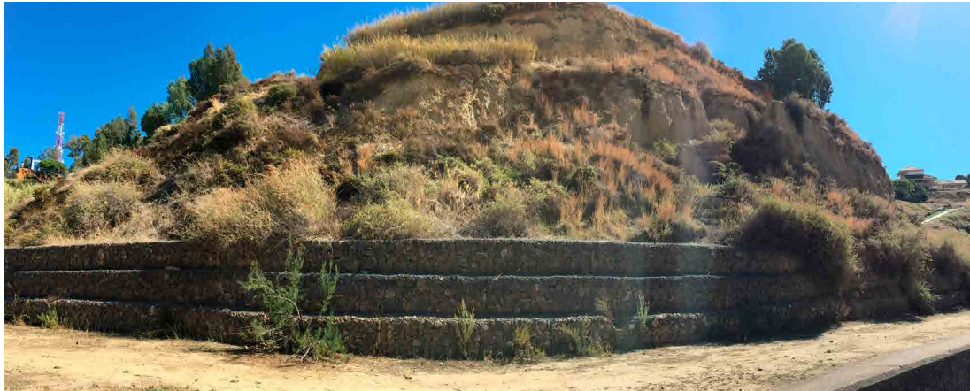
Figura 2. Fotografía panorámica de los Cabezos de Huelva en la zona de la Plaza de Toros. La fuerte pendiente de la cara oeste de los cabezos históricamente ha dado lugar a caída de rocas y problemas de estabilidad de los taludes.
