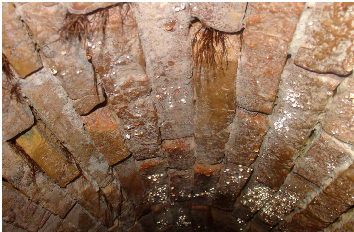
Figura 2. Filtraciones de agua en la bóveda del acueducto.
