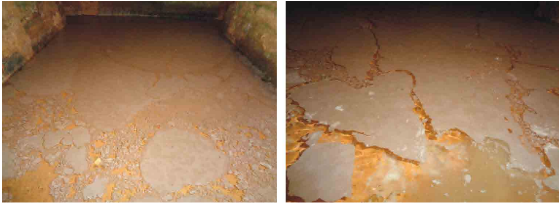
Figura 11. Fotografías de las finas láminas de precipitados de carbonato cálcico flotando sobre el agua que se forman en el depósito y las galerías de Fuente Vieja.
