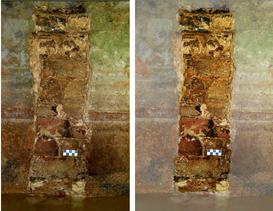
Figura 8. Empleo del opus latericium en la construcción del depósito constatado tras la capa de concreción calcárea.
