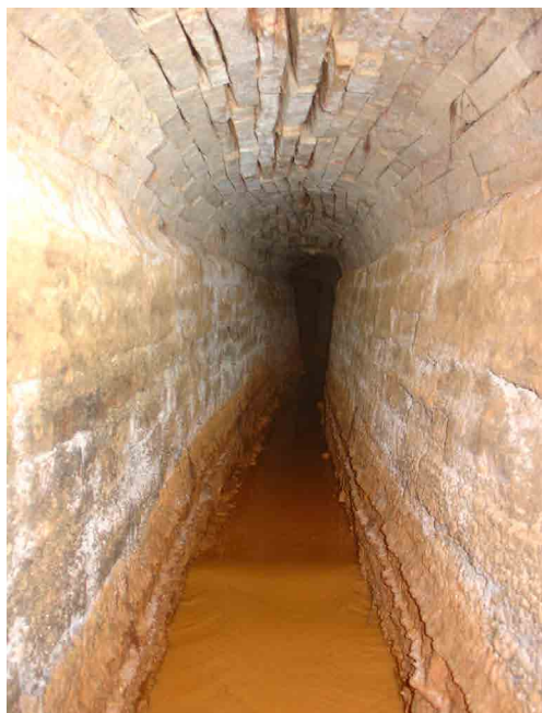
Figura 44. Imagen de la galería Sur, se aprecian las concreciones longitudinales a escasos centímetros del suelo.
