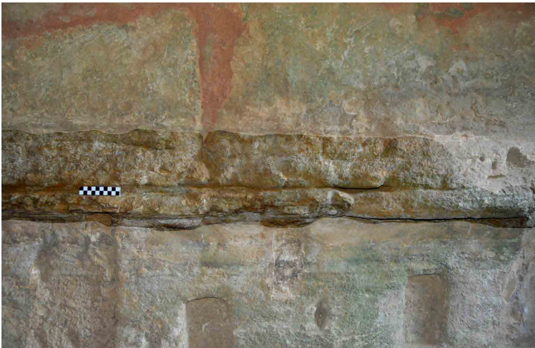
Figura 40. Concreción calcárea superior del paramento meridional.
