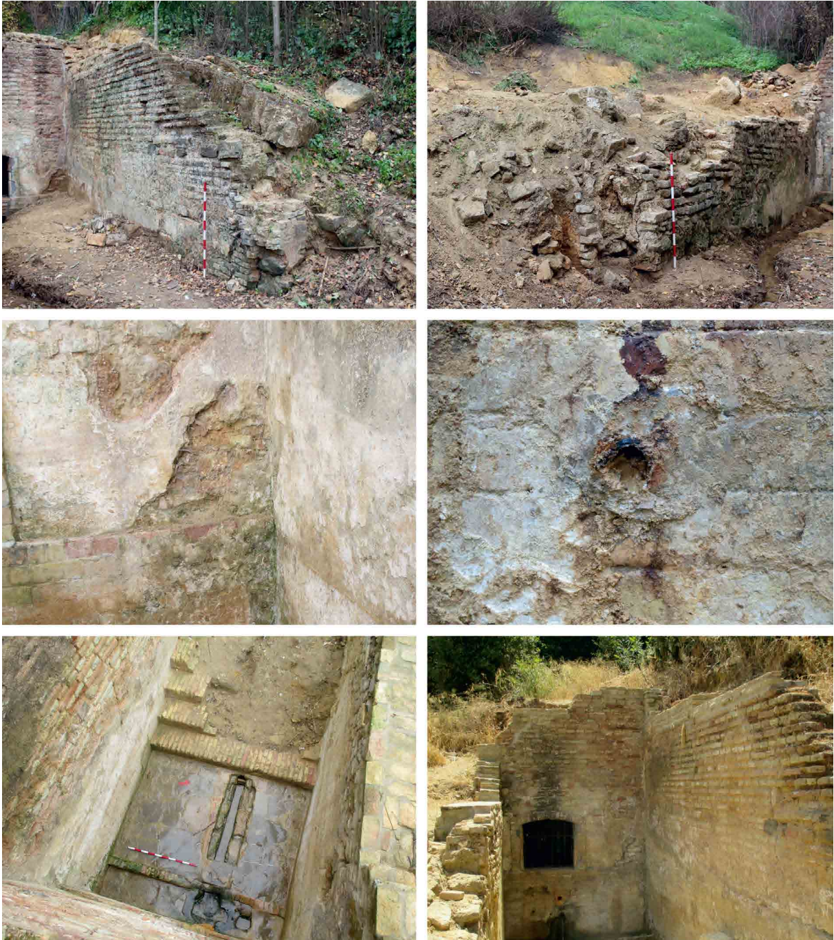
Figura 10. Detalles constructivos y de estado de conservación de la fuente.
