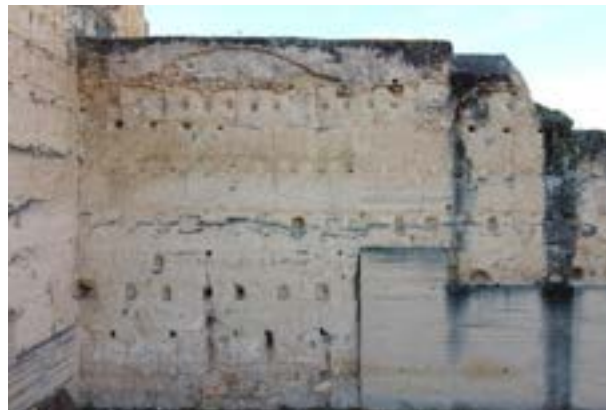
31 | Mechinales superiores que se corresponden con el emparamentamiento de las estructuras originales bajomedievales.
