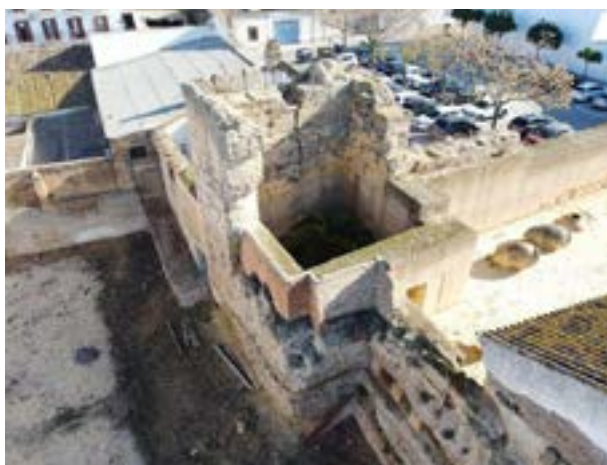
32 | Ruptura generalizada y desplome de la torre 3. Probablemente, por su grado de degradación y agrietamiento, ésta fuera una de las torres que colapsaron durante el terremoto de Lisboa en 1755.
