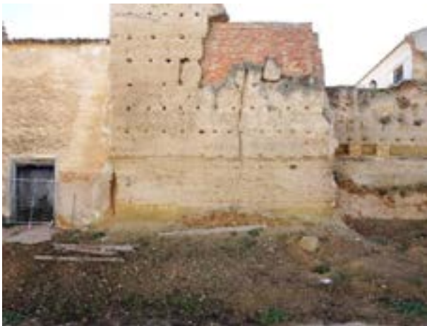
27 | Torre 3. Adviértase la faja latericia que daba arranque al alambor, muy deteriorado.
