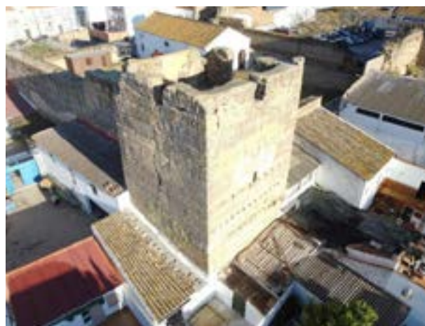
33 | Desplome de la torre 1. Solo cedió en este caso la cámara superior.
