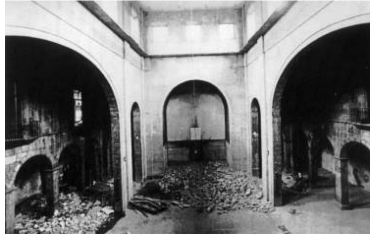
Interior del Convento, en donde se aprecia el Templo que fue construido en su interior y el estado de deterioro del edificio
