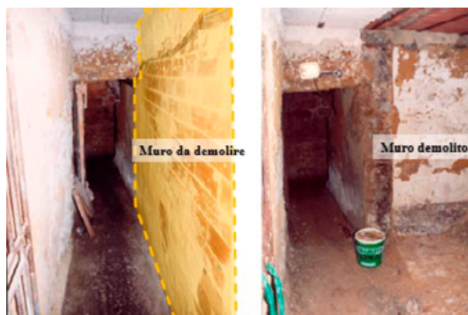
Fig. 169. Corridoio di accesso al crepidoma del tempio. Fasi successive di demolizione delle pareti divisorie dei vani del seminterrato. Fonte: Archivio Studio Sanzo Sajeva.
