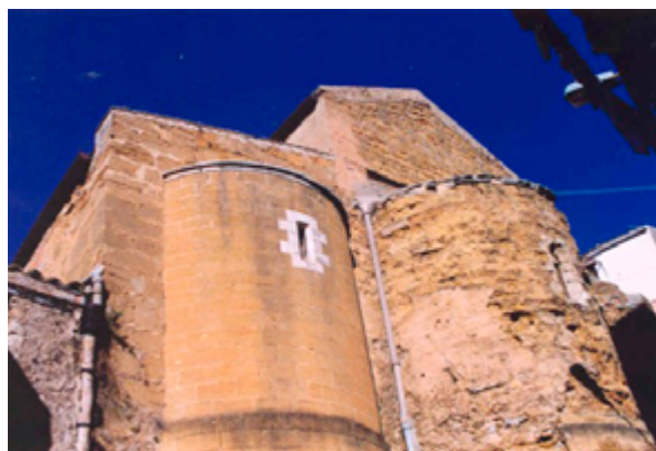
Fig. 99. Veduta angolo sud-est chiesa dopo l'intervento di restauro del Valenti e alla vigilia dei restauri del 2002. Fonte: Archivio studio Sanzo Sajeve.
