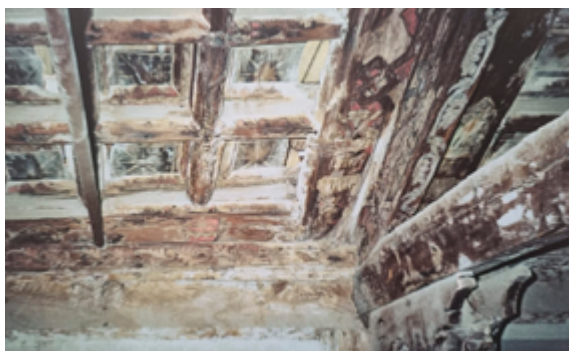
Fig. 231. Particolare capriata lignea decorata prima dell'intervento di restauro. Fonte: Ing. Giulio Sajeva.
