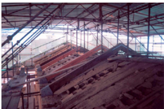
Fig. 220. Copertura Chiesa prima dell'intervento di restauro. Fonte: Ing. Giulio Sajeva.
