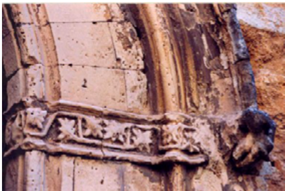
Fig. 139. Vista particolare portale di ingresso, prima dei lavori di restauro. Immagini tratte dalla Consulenza tecnica di diagnostica preliminare. Fonte: Archivio studio Sanzo-Sajeva.
