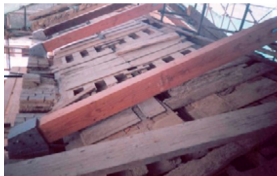
Fig. 221. Copertura Chiesa prima dell'intervento di restauro. Fonte: Ing. Giulio Sajeva.
